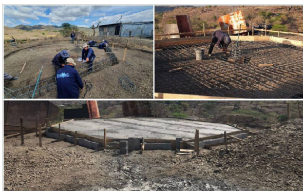
Sistema de Agua Potable
